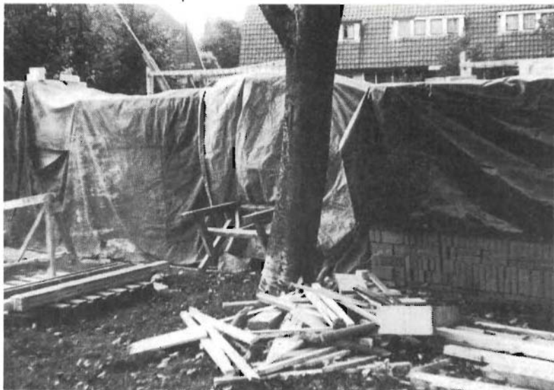
Bij bouwwerkzaamheden mag men onder de boomkroon geen verzamel- of stortplaats van bouwmaterialen creëren foto: Frank Moens
