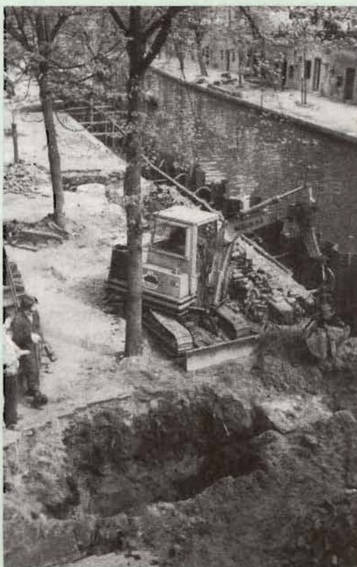
Bomen zijn maar al te vaak slachtoffer van renovatiewerkzaamheden. Kadereconstructie van de Oudegracht te Utrecht foto: A. Pek
